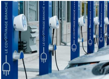
de recharge électrique
